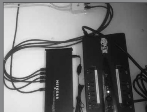
L'installation réseau : à gauche le multiplexeur et à droite le parasurtenseurs pour la protection contre les variations de courant (très important), et en haut les connexions pour les caméras.
