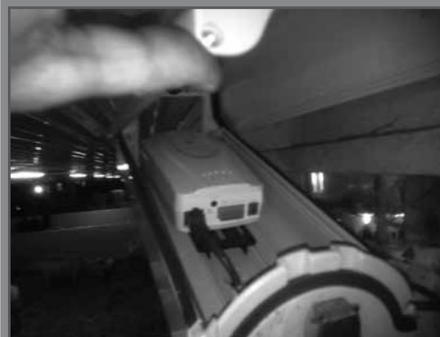
Caméra à l'intérieur du boîtier, remarquez le branchement avec le fil réseau.
